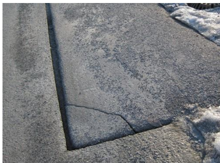
Uriktig utført asfaltskjøt uten fortanning
