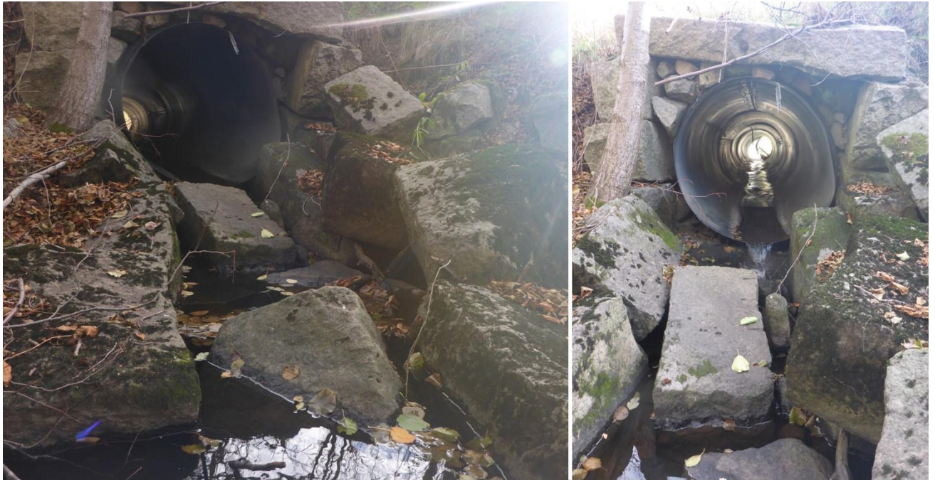
Figur 14. Utglidning av forbygningen har medført at steinblokker kan hindre oppvandring av gytefisk gjennom kulverten. Foto er tatt på svært lav vannføring høsten 2018.
